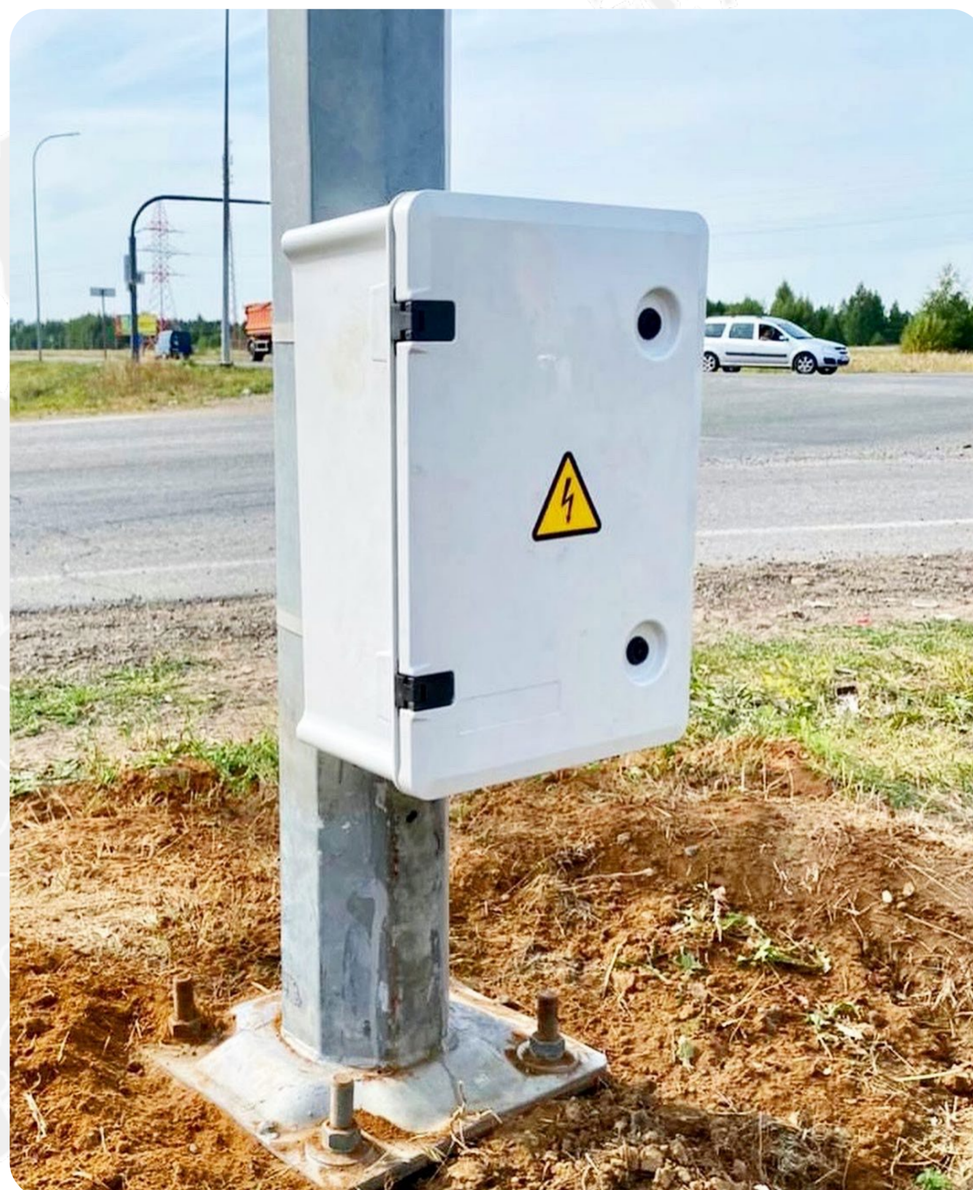
ЭЛЕКТРИЧЕСКИЙ ШКАФ ИЗ МАТЕРИАЛА ПОВЫШЕННОЙ КОРРОЗИЙНОЙ СТОЙКОСТИ
